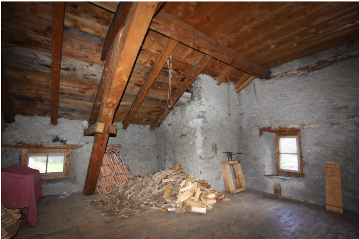
Holzlager im Estrich
