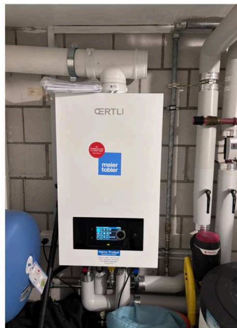
Technikraum · Heizung 2025 ersetzt
