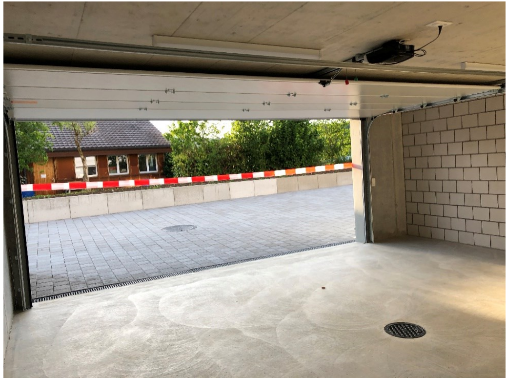
UG: Doppelgarage mit Sektionaltor, mit Ventilator belüftet
