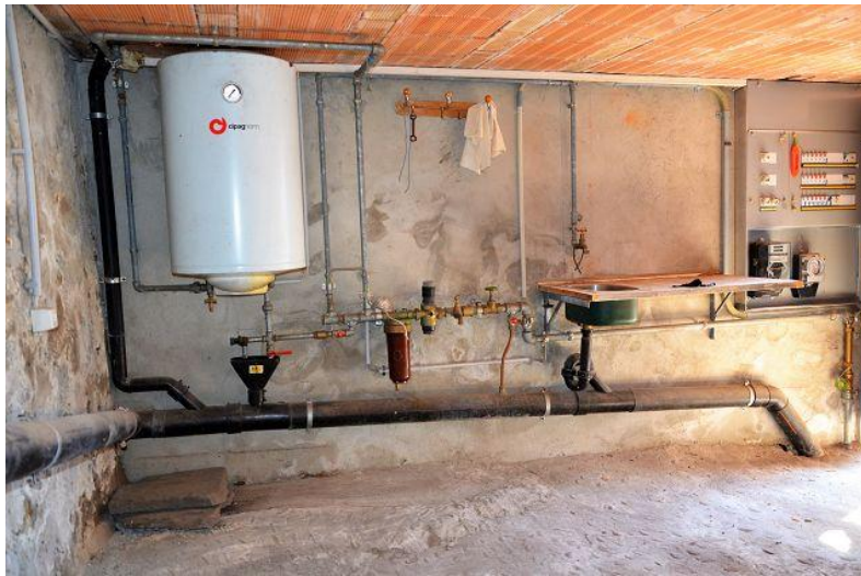
Technischer Raum / locale tecnico
