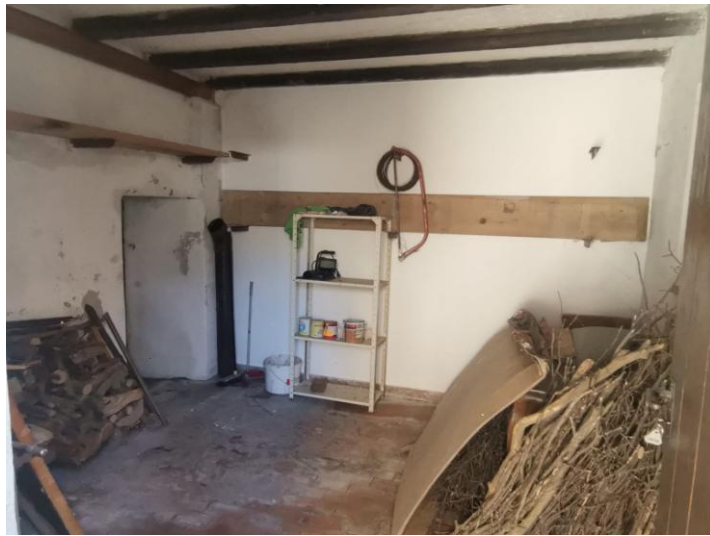
Heizungsraum / locale tecnico
