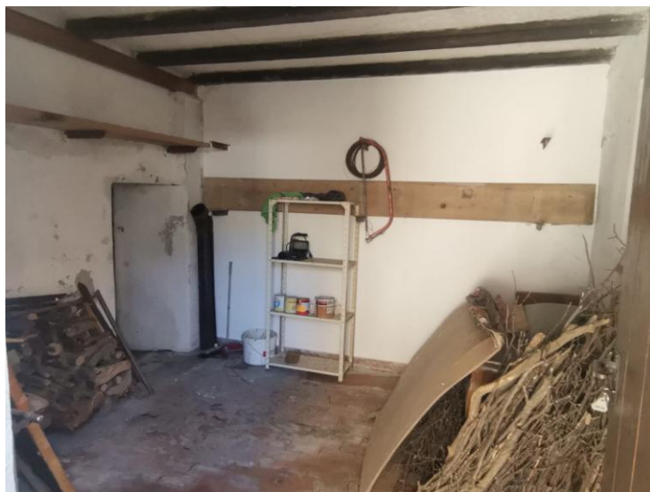
Heizungsraum / locale tecnico
