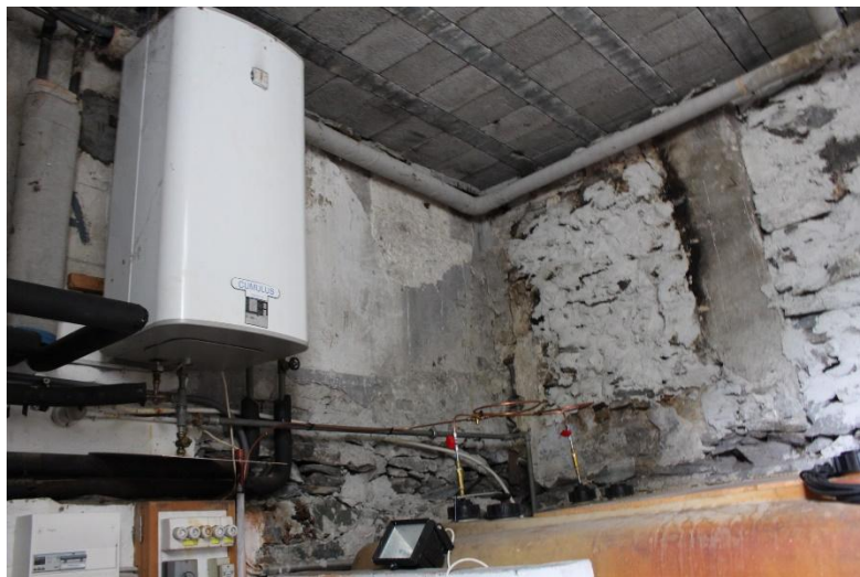
Keller – Technische Raum / cantina – locale tecnico
