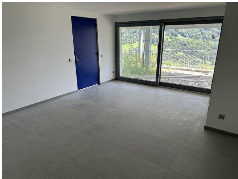
Wohnraum im Erdgeschoss / soggiorno nel PT
