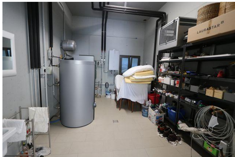
Heizungsraum / locale tecnico
