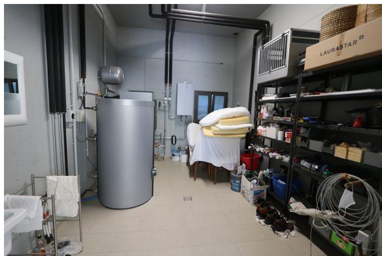
Heizungsraum / locale tecnico
