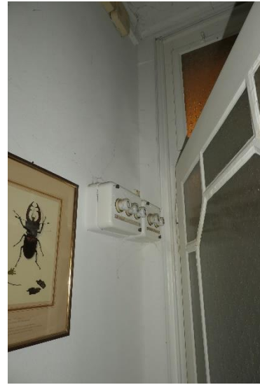
Vorplatz: Wohnungssicherungen alt 1.OG
