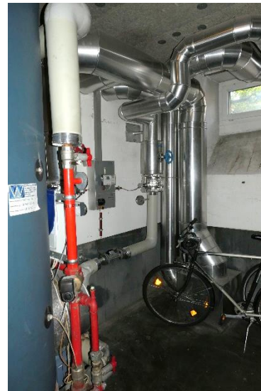
Heizungsraum mit Fernwärme
