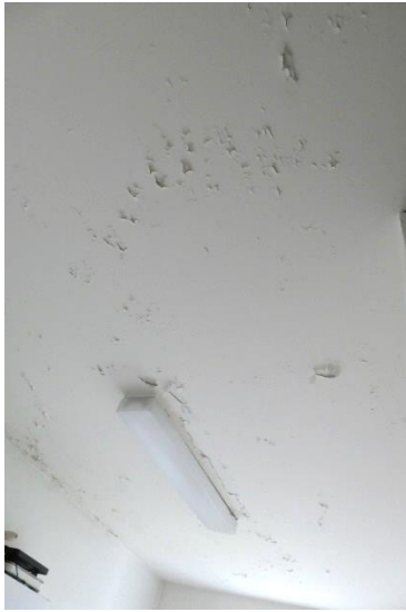
Küche: Decke, Farbabblätterungen 1.OG
