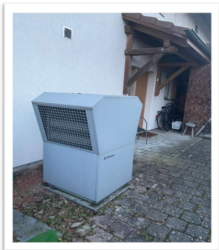
Wärmepumpe (Dimplex, 2,5 kW,)
