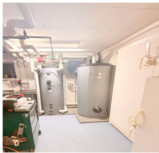
Warmwasser & Heizung in der Waschküche
