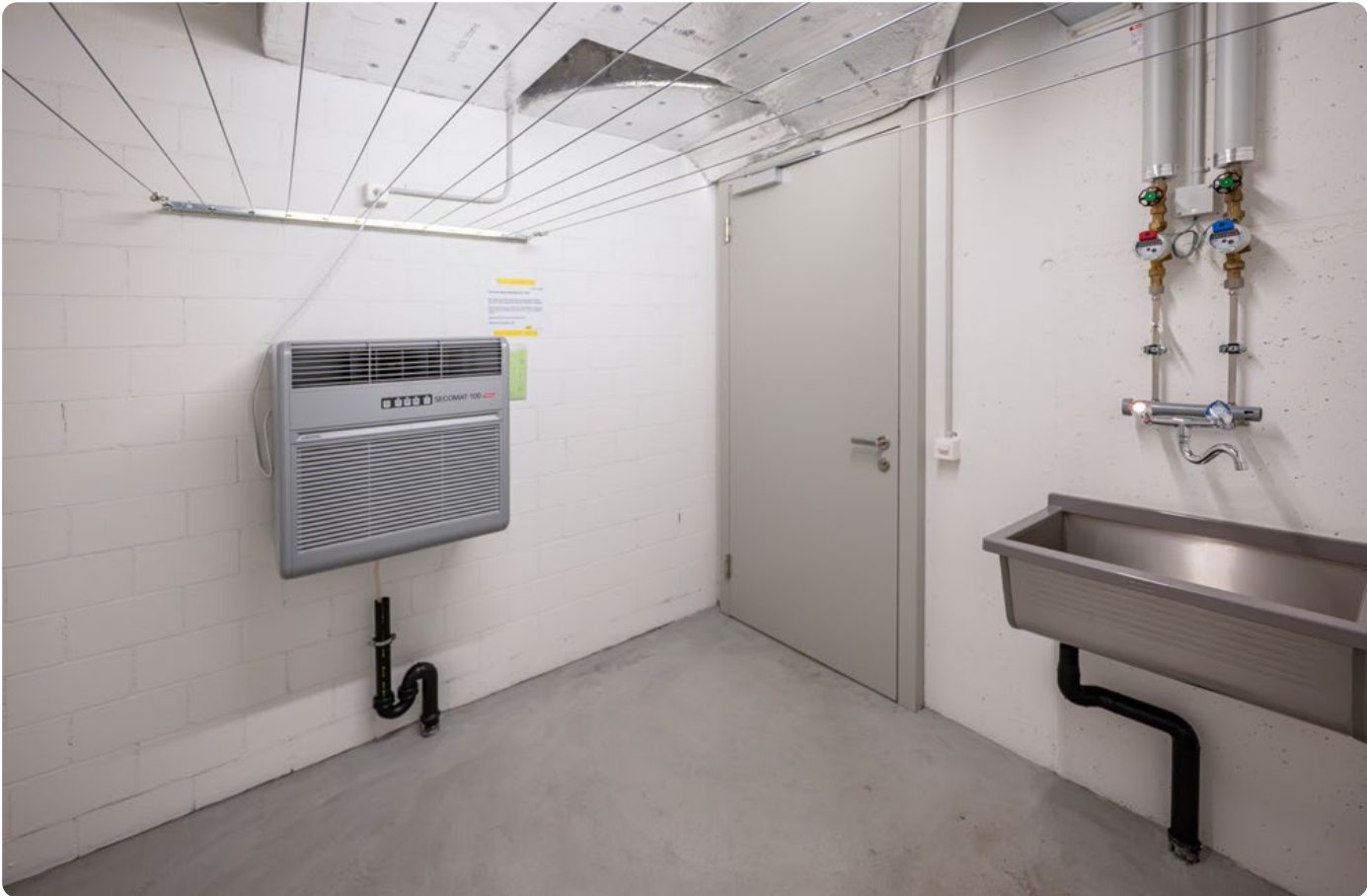
Trockenraum zur Mitbenützung
