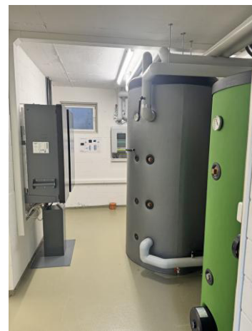
Technikraum | WP mit Aussengerät, Wasserspeicher, Wechselrichter, Batterie
