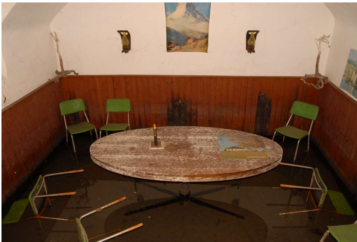
Cave avec inondation d'environ 20 cm continue
