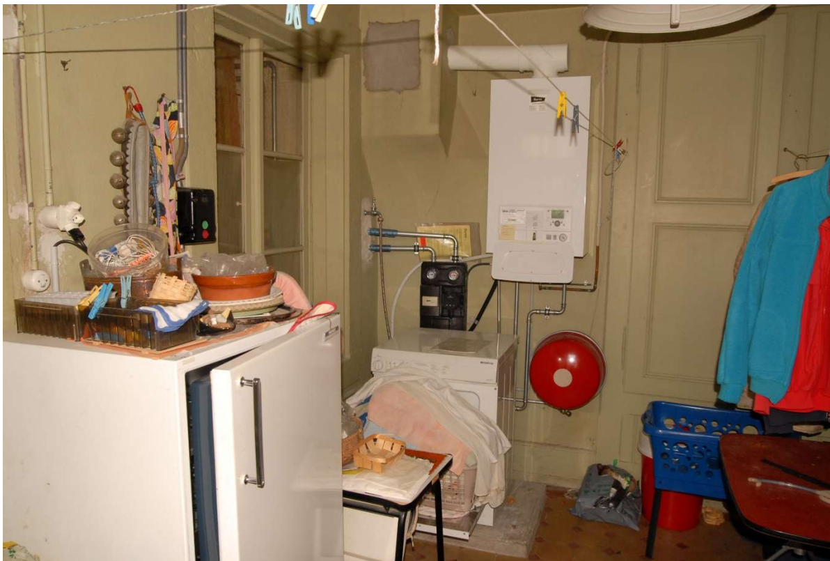
Réduite avec chaudière à gaz dans l'appartement du rez-de-chaussée
