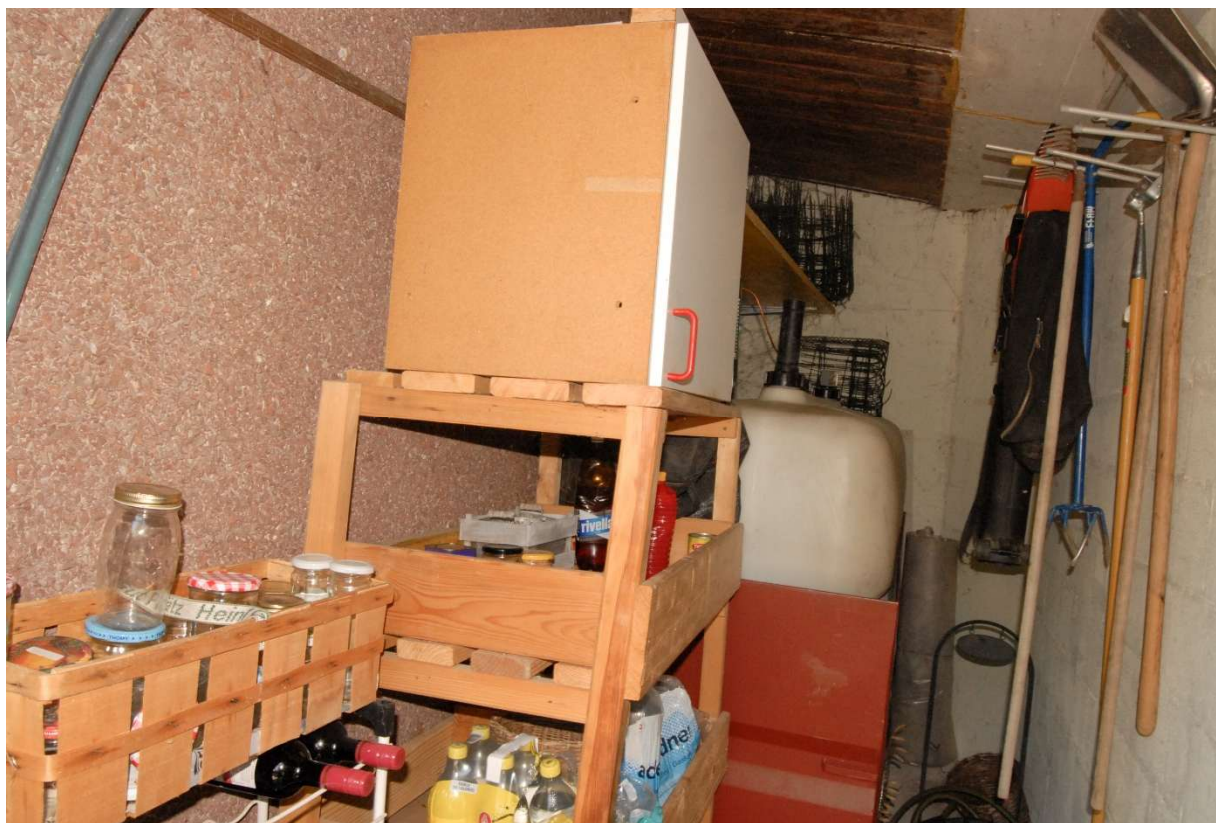
Local citerne avec citerne à mazout en plastic de 2'000 litres
